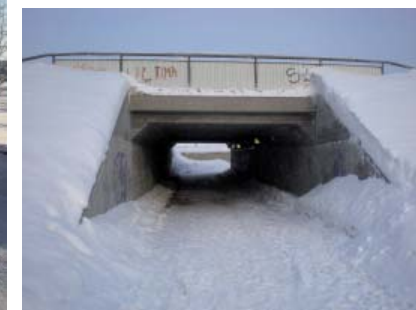
Figur 51. Det enda gång- och cykelstråket mellan Strandängarna och centrum går genom en mörk tunnel.
