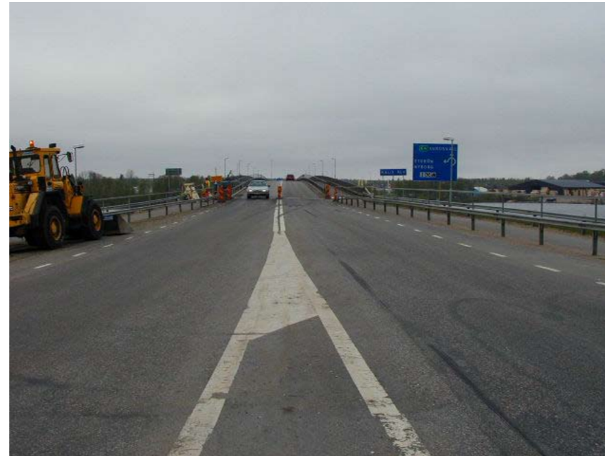
Bron över Kalixälv är i stort behov av omfattande reparationer.
